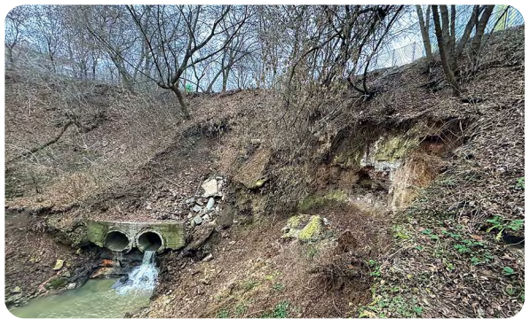
Рисунок 2.70 – Оползень на левом склоне долины р. Коршунихи вблизи Севастопольского проспекта
