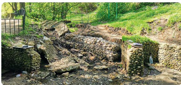
Рисунок 2.57 – Разрушенный участок дренажного лотка в тальвеге Голосова оврага
